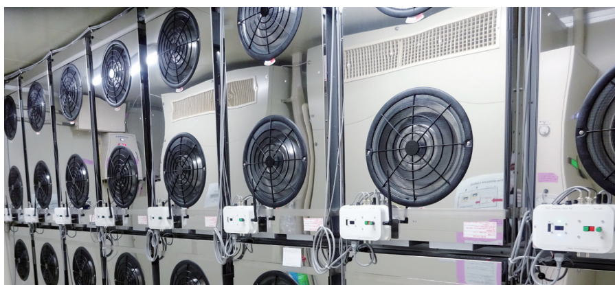
図2 C棟クリーンルームで稼働中のFFU制御ユニットV2 現在は上段の8台のFFUの風量を24時間制御している
