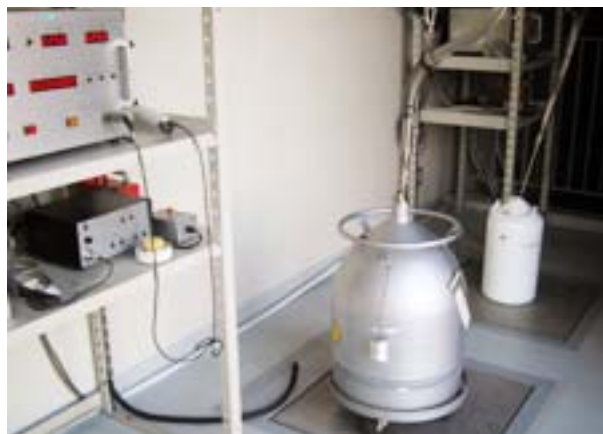
写真1 山手4号館2階東側の液体窒素自動供給装置(2台)
