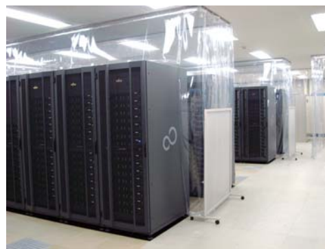
図2 計算科学研究センター旧棟のスパコンに設置されたカーテン。
