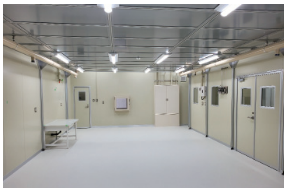
共同研究棟C棟（旧レーザー棟）クリーンルーム。
