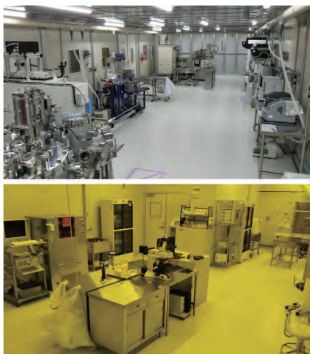
図2 クリーンルームの写真
