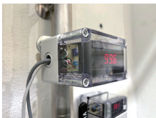
写真1 ヘリウム純度計。配管設置型（中央）、置き型（下奥）
